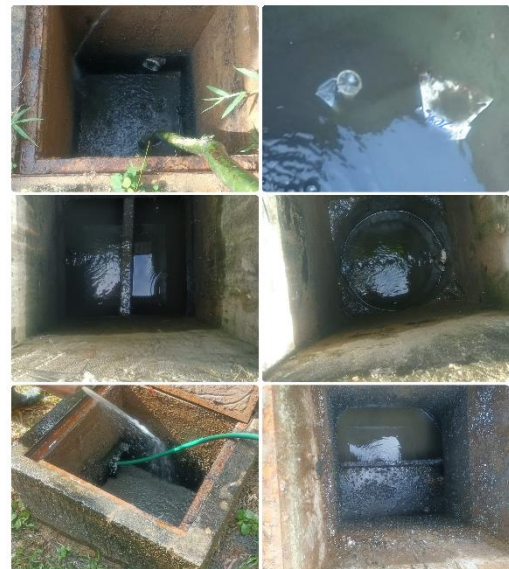
Imagen 25. Estado en el que estaba el drenaje de la Unidad de Servicios Habitacionales de la URUSSE..
